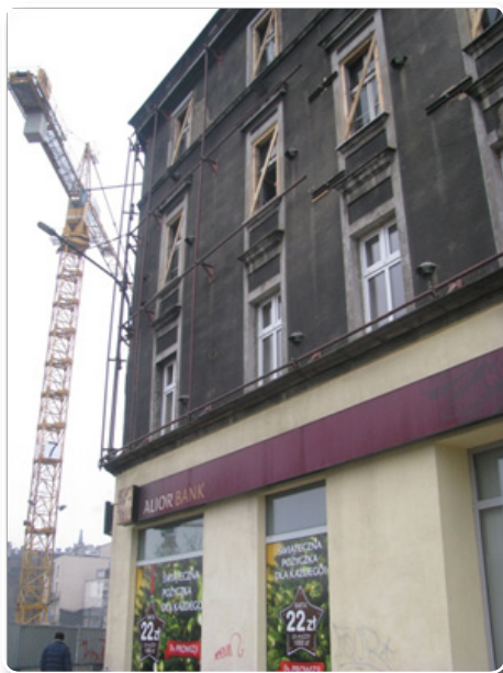
Uszkodzona kamienica - ul. Młyńska
